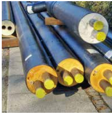
Fjernvarmerør virker meget tykke, men isoleringer fylder det meste: Foto: PN Rørteknik
